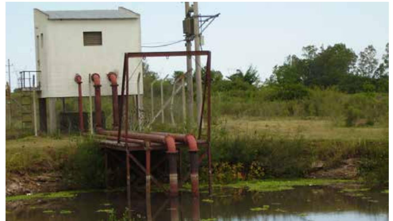
Toma directa - típica extracción de bombeo – Fotografía DINAGUA
